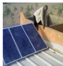
Solarstrom am Dach
